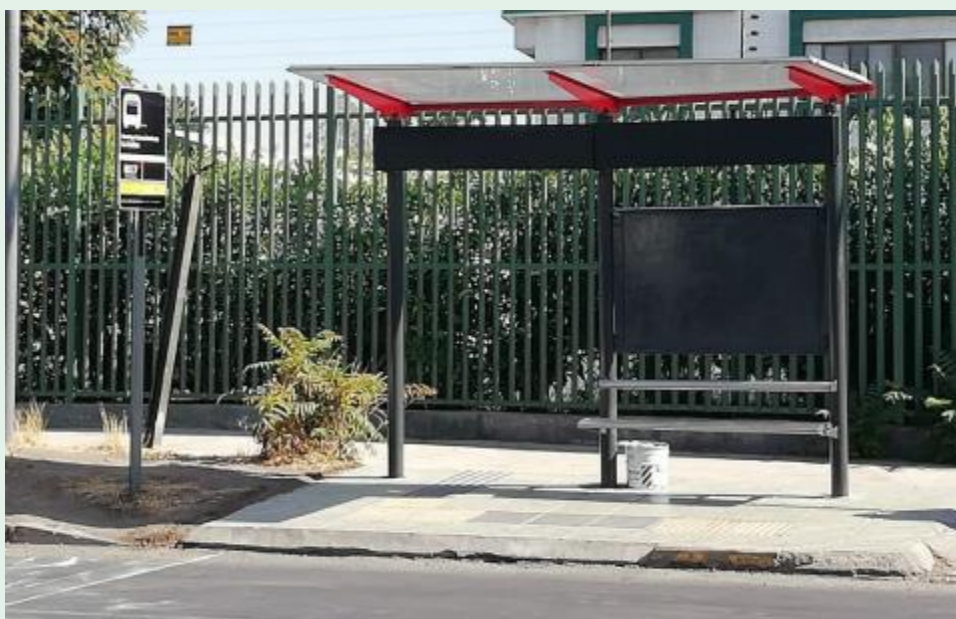
Fotografía 88. Refugio peatonal instalado
